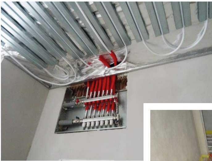
▲ Stropní vytápění a stopní chlazení
